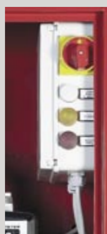
GE Particolare quadro elettrico con spie luminose di riserva e blocco pompa al minimo livello
